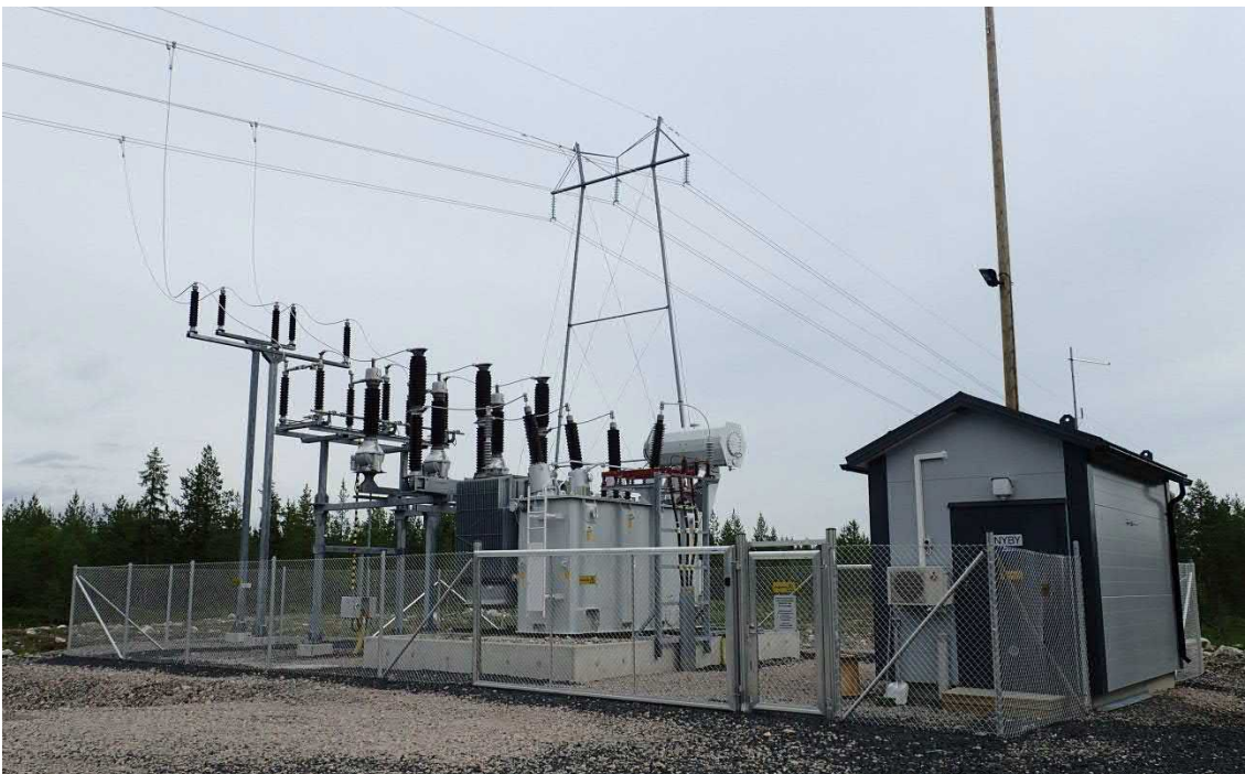
Kuva 4.9. Esimerkki tuulivoimapuiston sähköasemasta (kuva Minna Takalo/FCG).
