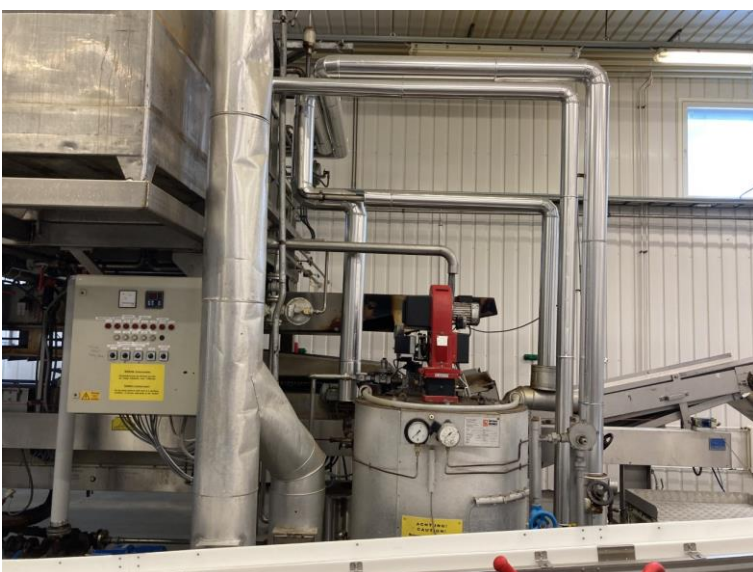
Tehtaan sisäpuolella oleva käyttölaitteisto
