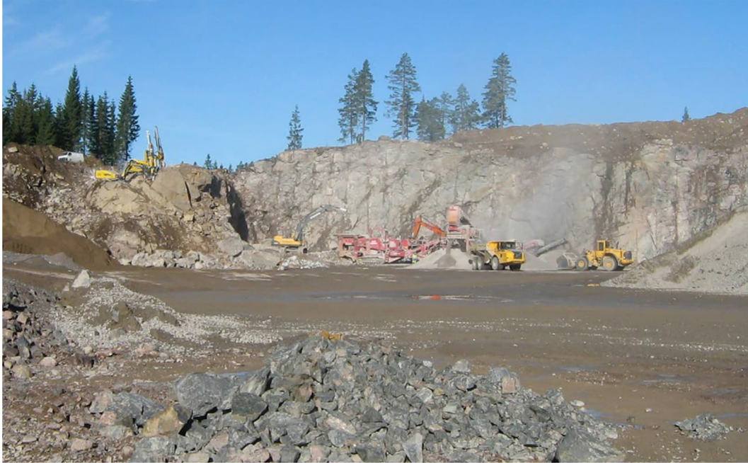
Kuva 6-2. Esimerkki kiviainesottoalueen toiminnasta. Kuvassa vasemmalla porausta, keskellä murskausta, oikealla kuljetusta ja varastointia. Kuva ©: Ympäristöministeriö 2020 / Jari Rintala.
